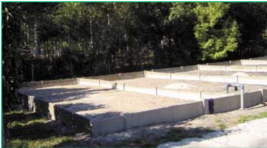
Stockage et séchage des boues
