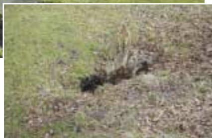
Terrier à l'origine d'effondrement des berges
